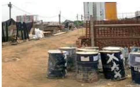
Figura 2. Visita en obra; identificación de Residuos de la construcción y la demolición. Canecas metálicas usadas. Foto propia.
